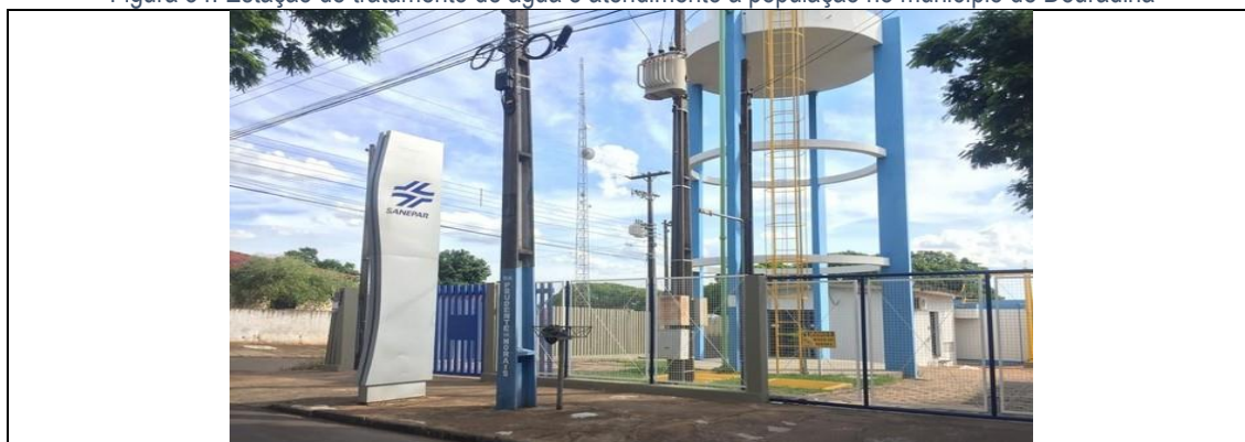
Figura 34: Estação de tratamento de água e atendimento à população no município de Douradina
