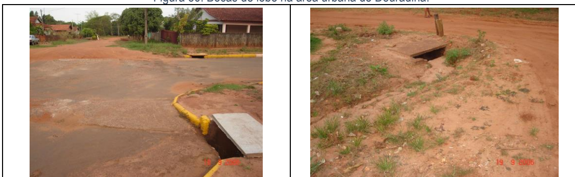
Figura 36: Bocas de lobo na área urbana de Douradina.
